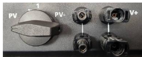
Interrupor de aislamiento FV
